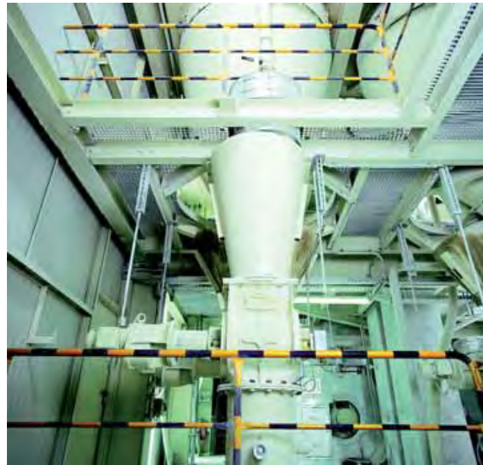
Hydratanlage Hahnstätten, 1999 Hydrated lime unit in Hahnstätten, 1999
