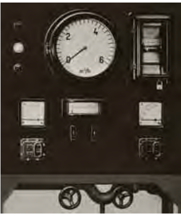
Leitstand · Control panel
