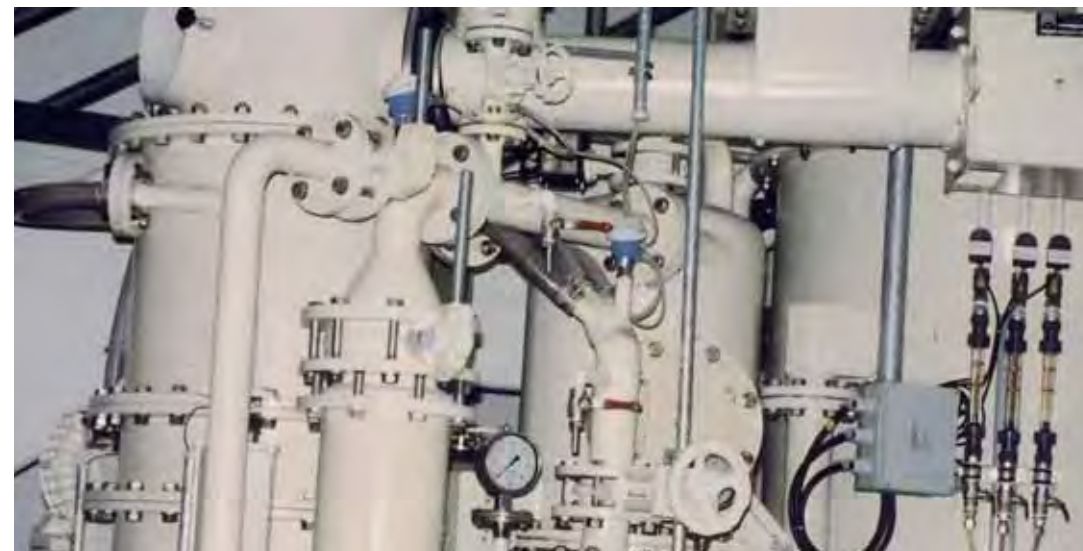
Kalkmilchanlage im Wasserwerk Eich, 1994 Milk of lime unit at Wasserwerk Eich, 1994
